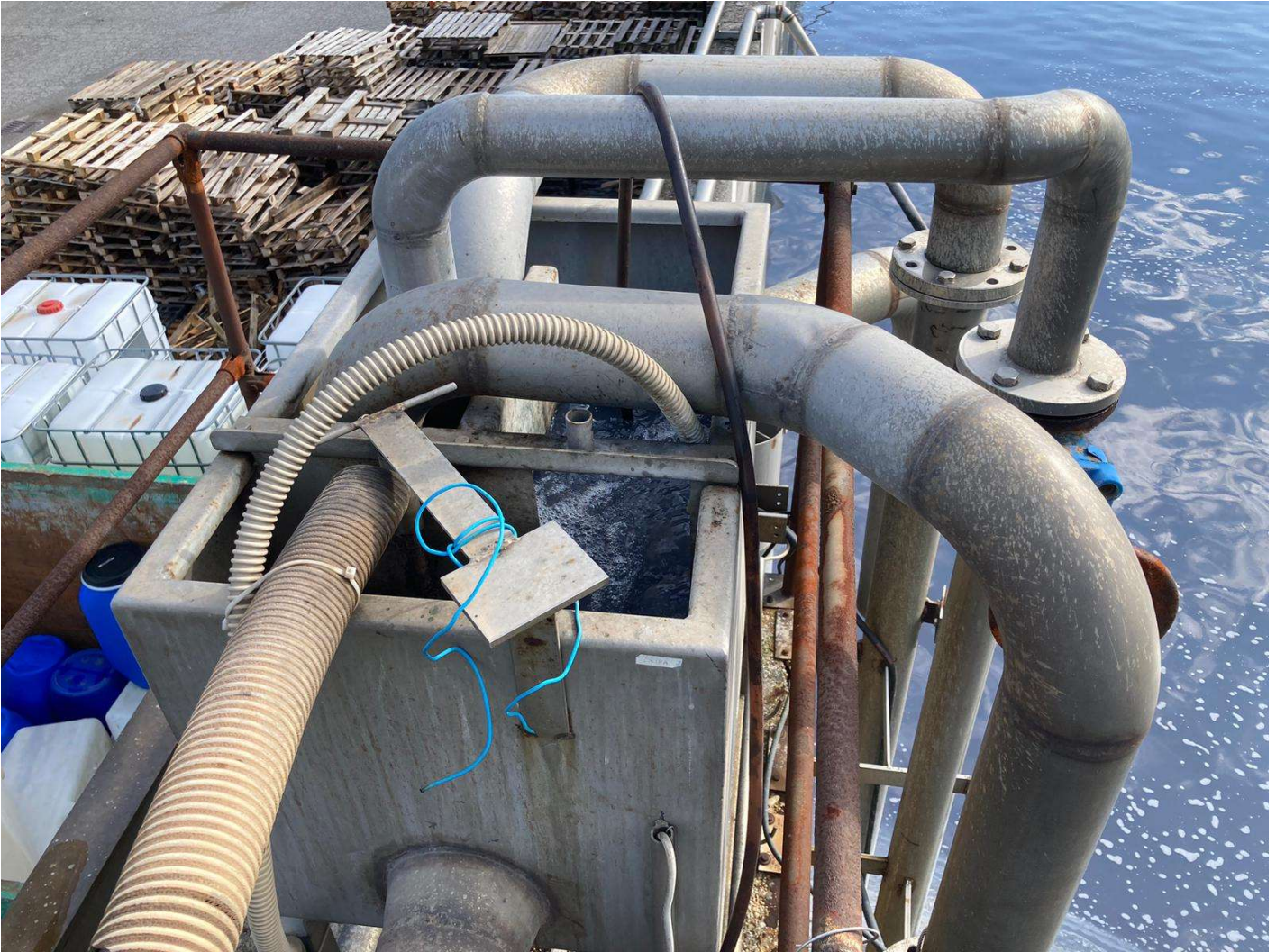
Vasca di accumulo acqua pre-trattamento
