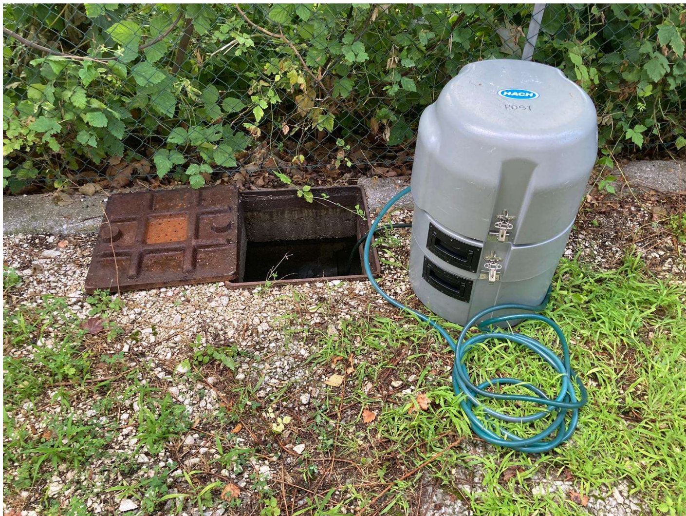
Pozzetto acqua post-trattamento
